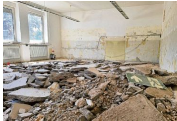
In der Bäumenheimer Schule war tonnenweise asbesthaltiges Material verbaut.
